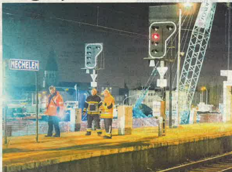
Spoorarbeiders bekijken de schade aan de sporen. FOTO PATRICK HATTORI
