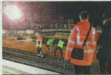
Een inspectieteam merkte een verzakking op aan spoor negen.
